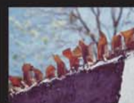
Cacos de Vidro nos Muros
